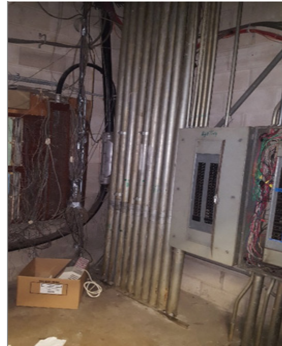
Fig E-4 - Wiring in Conduit
